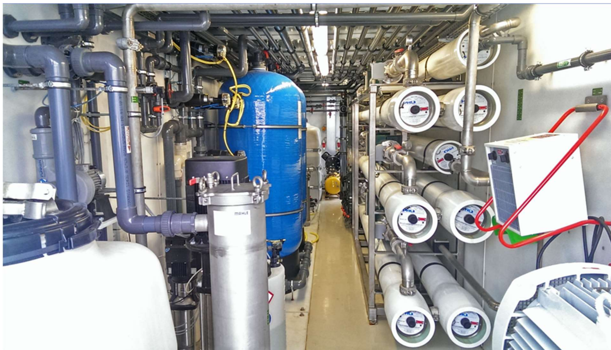
Рис. 16 - Внешний вид контейнерной Установки обратного осмоса по очистке фильтрата полигона
